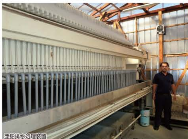
亜鉛排水処理装置
