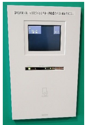
改修後の各室カードリーダー
