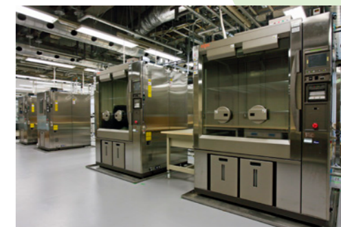
前面ガラス恒温恒湿槽 (実証試験セクター)
