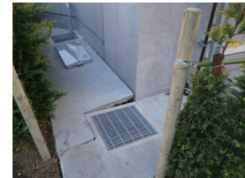
地震のひずみによる建物外周部のズレ
