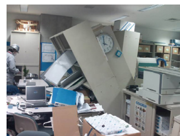
移転直前に被災した本部管理事務所
