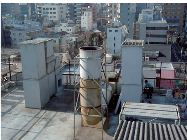
図7 塗装工場からの排気ダクト 都内では住宅と工場が混在しておりVOC発生工場にとって処理装置の低価格化・小型化は必須条件です
