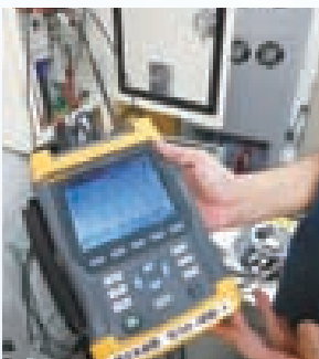
配電盤の電流・電圧を測定
